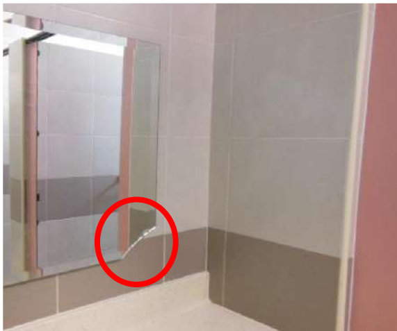
Cermin pecah Lokasi: Bilik KT34, AE53 Jabatan Sajian Dan Kecemasan
