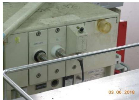
Ventilators (Wad 6D) Lokasi: Pusat Pengumpulan Pelupusan HKL
