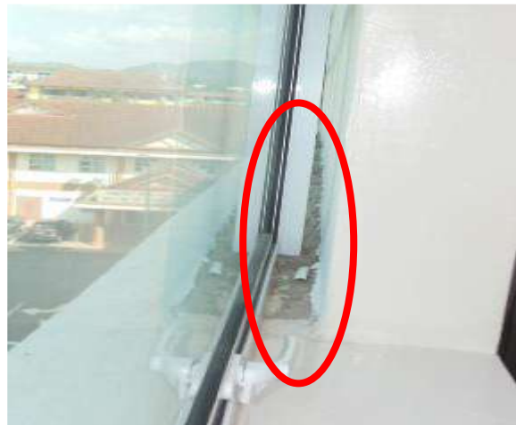
Kemasan Tidak Sempurna Lokasi: Bilik Ruang Bersih, Jabatan CSSD
